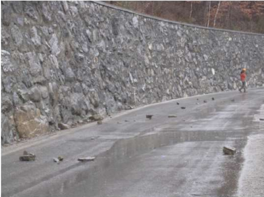
Elementi lapidei disgiunti lungo la zona di scorrimento e caduti sulla strada.
